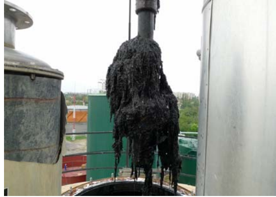
2.fénykép A rothasztó keverőre rácsavarodó szálak anyaga, amely a keverést akadályozza
